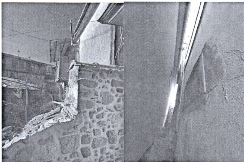
Φωτ : Αριστερά: Λεπτομέρεια εξώστη εντός αύλειου χώρου Φωτ 8: Δεξιά: Λεπτομέρεια γειτνίασης με διπλανή ιδιοκτησία
